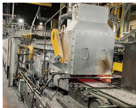
焼結炉集約操業(焼結炉参考)
