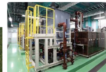
浸出水処理施設内に設置された「Eleca®」 納入台数：3台
