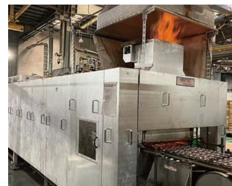
焼結炉集約操業(焼結炉参考)
